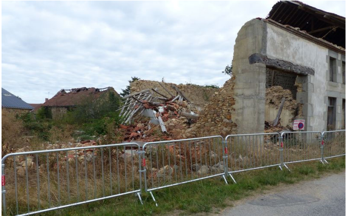
Bâtiment écroulé au Breuil
