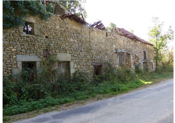
Bâtiment en ruines à Vaureix
